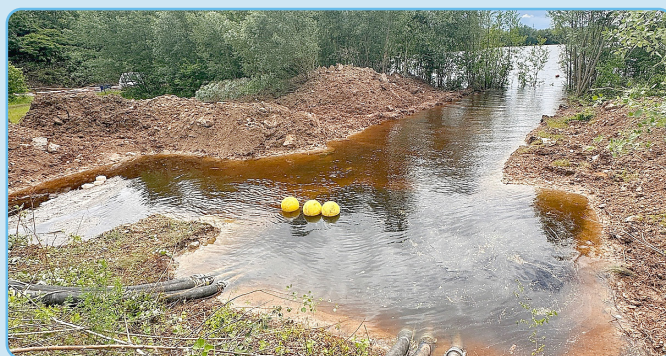
Beim letzten Hochwasser wurden hier die Wassermassen bekämpft. Foto: Mike Schönlaub
